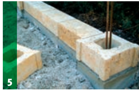
5 W ten sposób zostaje osadzona pierwsza warstwa muru wraz z elementami słupów.
